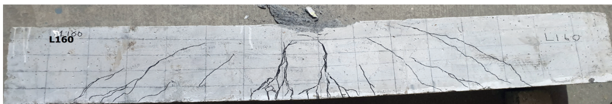
d) L160 Wzorec pęknięcia belki - zniszczenie przez zginanie d) L160 Beam crack pattern at ultimate – failed in flexure
